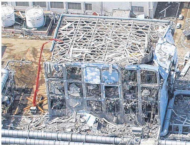
Zerstört: Auch ein Jahr nach dem GAU sind weiter täglich 3000 Arbeiter in der Atomruine erhöhter Strahlung ausgesetzt. Schätzungen zufolge dürfte der vollständige Rückbau des Atomkraftwerks bis 40 Jahre dauern.
